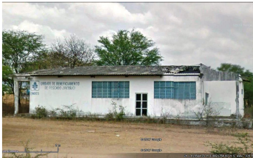
Foto 13: Unidade de Beneficiamento do DNOCS, em Rômulo Campos. Fonte: Google Street View , 2017.
