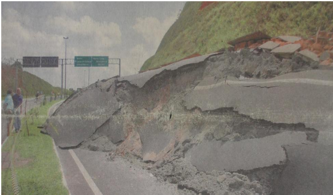
Figura 11 – Trecho da Avenida danificado pelo deslizamento de terra
